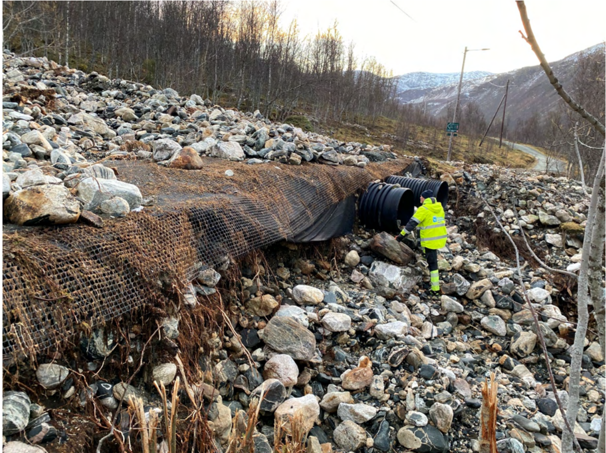
Figur 49: Flomhendelsene 8. november 2024 skapte utfordringer for infrastruktur mange steder i Troms fylke, her ved flomskred som tok med seg turveien ved Skavet i friluftsområdet i Tromsdalen. I tillegg til skadene fra skredet, gjorde store vannmasser skader på det øvrige turvegnettet og flere bruer. Arbeidene med å rydde opp skadene etter flommen i friluftsområdet pågår fortsatt per 2025, og de totale kostnadene antas å lande på et sted mellom 5 og 10 mill. kroner bare for friluftsområdet. Naturskade som oppstår i bebygde områder, vil raskt medføre et betydelig høyere kostnadsbilde. Foto: Magne Hestem.
