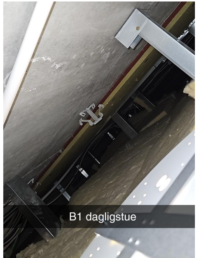
Figur 10 – Flenskant mangler brannisolasjon
