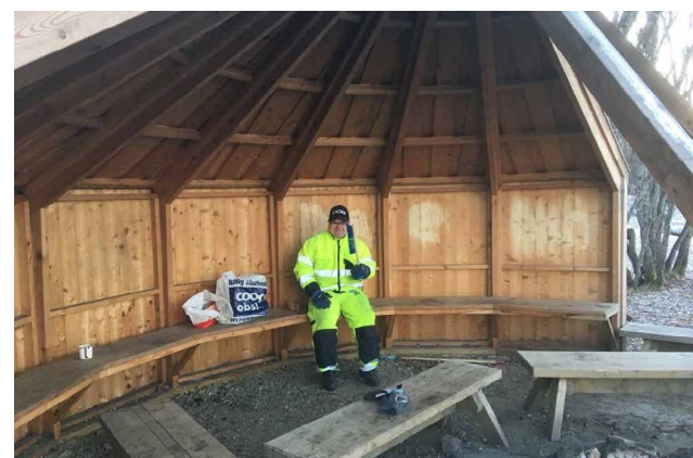
Sliper vekk tagging i gapahuken på Charlottenlund
