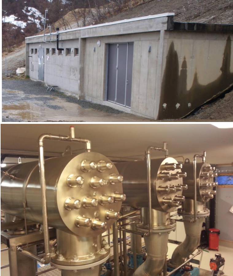
Figur 11: Kvaløya Vannbehandlingsbygg (øverst) med eksisterende UV-aggregat (nederst).
