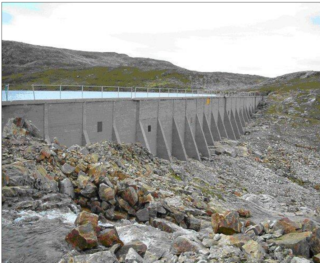
Figur 9: Damanlegget ved Amundvatnet.
